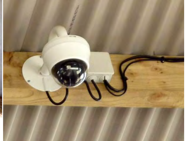
Figur 35 Overvågningskamera i kælvningsstalden
