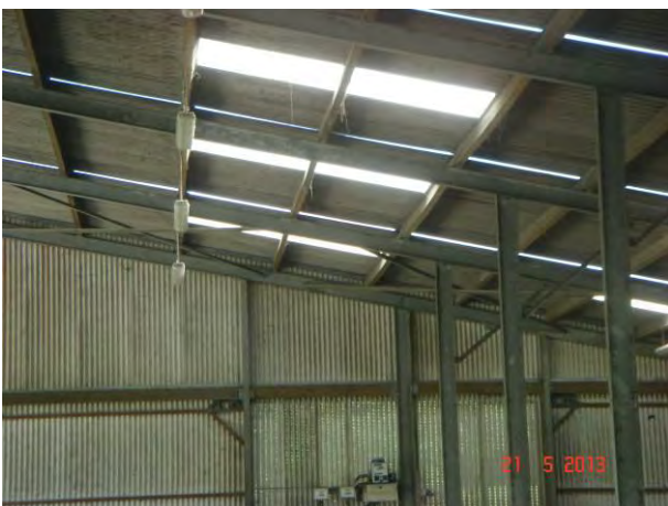
Figur 22 Stolpekonstruktion med kryds og tag med langsgående sprækker.
